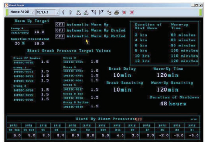
Figura 34. La pantalla Sheet Break permite a los operadores vigilar y controlar todas las variables de los procesos esenciales de secado durante las operaciones automáticas.
