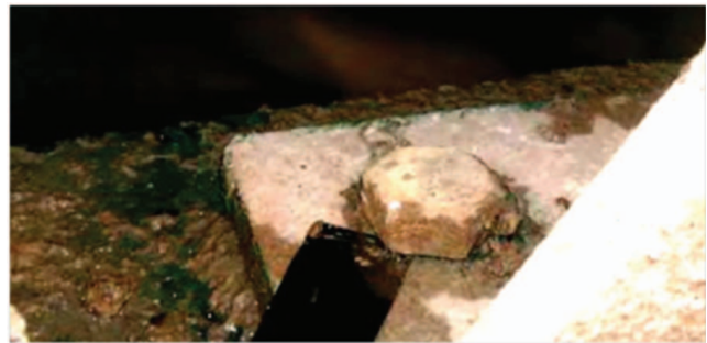
Figura 12. En esta fábrica había arandelas de bloqueo que estaban completamente corroídas. Todos los elementos de sujeción que no estén en buenas condiciones debe reemplazarse con elementos de acero inoxidable lubricados, en caso de que fueran de acero dulce estándar.
