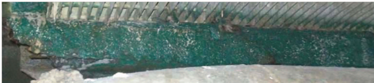
Figura 13. El extremo de este soporte de pasillo está totalmente corroído de lado a lado y gran parte del material ya no existe. Otras partes del soporte también presentan delaminación en curso. Esta pieza tendrá que ser reemplazada.
