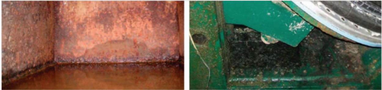
Figura 11. Estas áreas están llenas de agua estancada. Al realizar los orificios de drenado se evitará que se acumule agua en el bastidor en el futuro.
